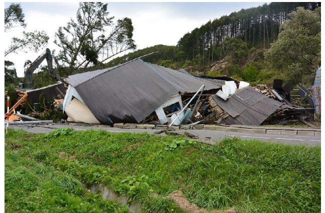
厚真町の土砂崩れ現場（現地調査）
